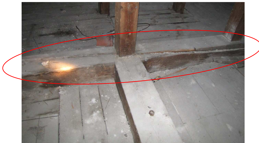
Fot. 2. Pęknięcie podłużne nadciągu z przemieszczeniem
