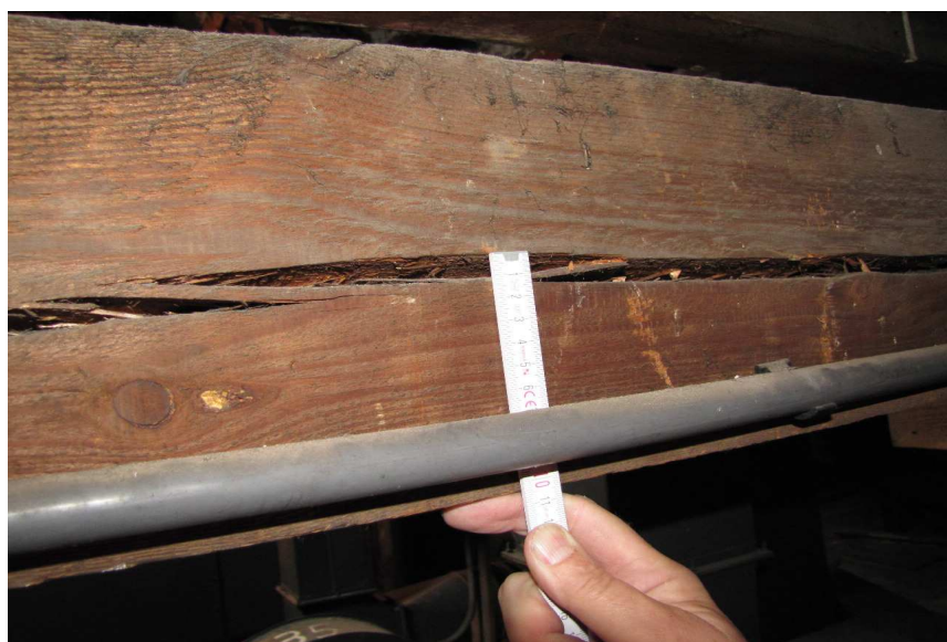
Fot. 3. Większość elementów drewnianych więźby dachowej znacznie popękana. Na zdjęciu widoczna jedna z belek wiązara
