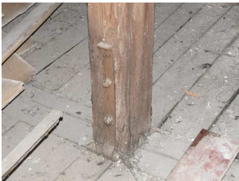
Fot. 5. Wszystkie stalowe łączniki oczyścić i zabezpieczyć antykorozyjnie za pomocą powłok malarskich
