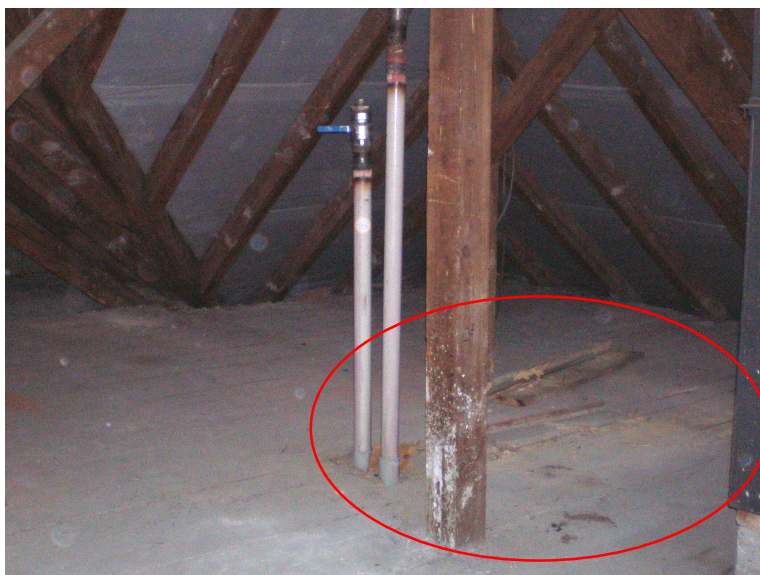
Fot. 4. Podłoga – deski gr.2,5 cm do wymiany
